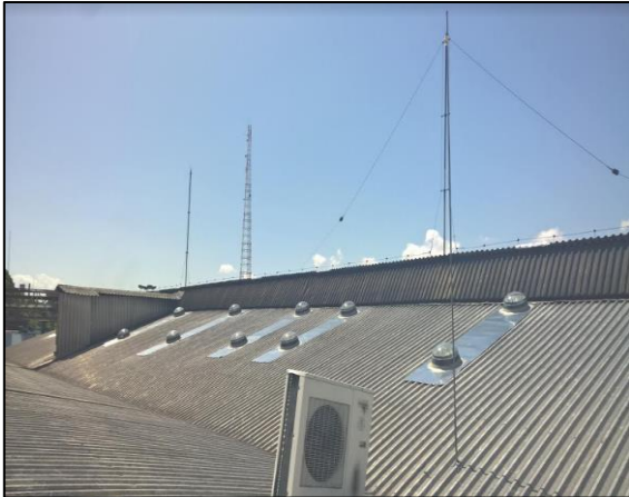
Figura 3: Sistema de Iluminação natural instalado.
