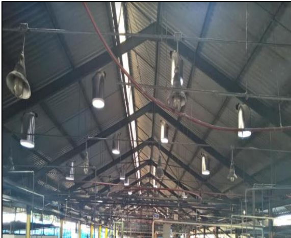
Figura 4: Sistema de Iluminação natural instalado.
