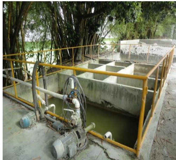
Figura 5B - Caixas de Decantação.
