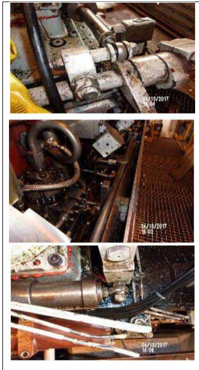
Figura 7 - Sistema de inspeção no sistema de bomba injetora.
