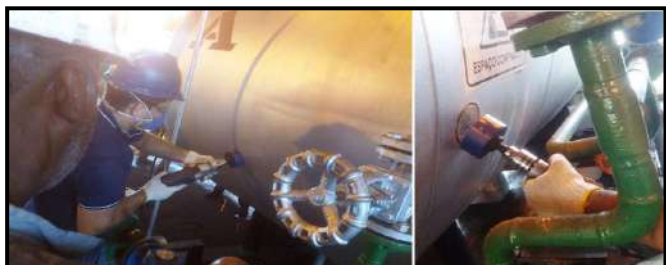
Figura 7: Abertura de janelas no isolamento para medição do casco cilíndrico nas laterais da caldeira. Fonte: Autores, (2019).
