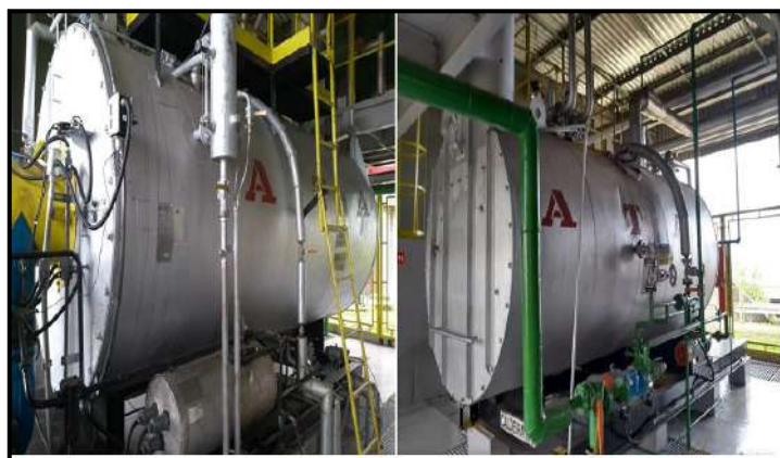
Figura 5: Vista geral da caldeira nº2. Fonte: Autores, (2019).
