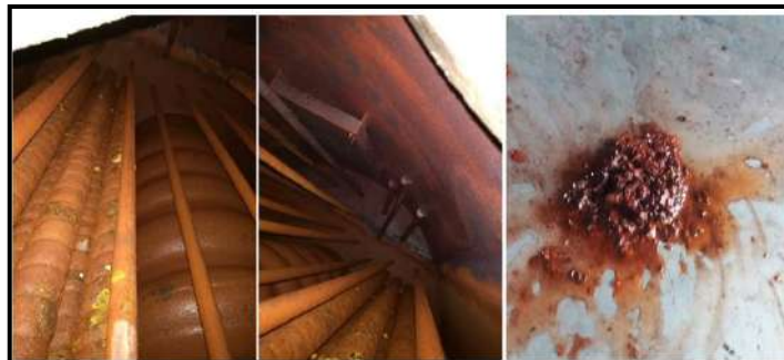
Figura 14: Exame interno e amostra de ferrugem retirada.
