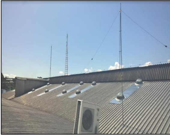
Figura 3: Sistema de Iluminação natural instalado.
