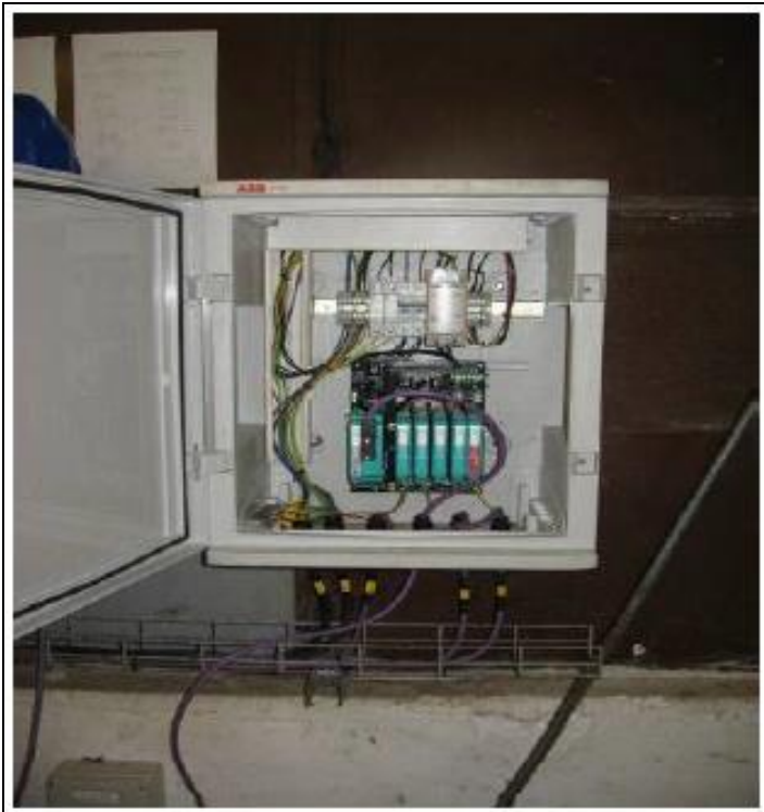
Figura 6: Profibus Power Hub ubicado en el campo. Fuente: Los Autores, (2015).
