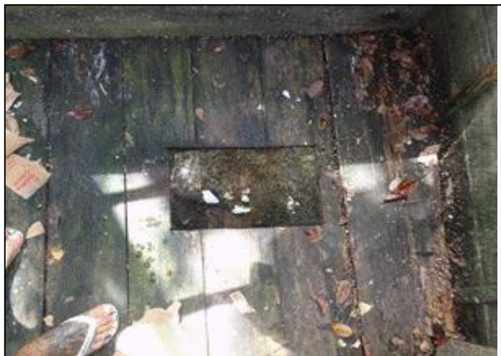
Figura 4: de Banheiro sem Tratamento – PAE Pacajaí I. Fonte: IATAM (2015)
