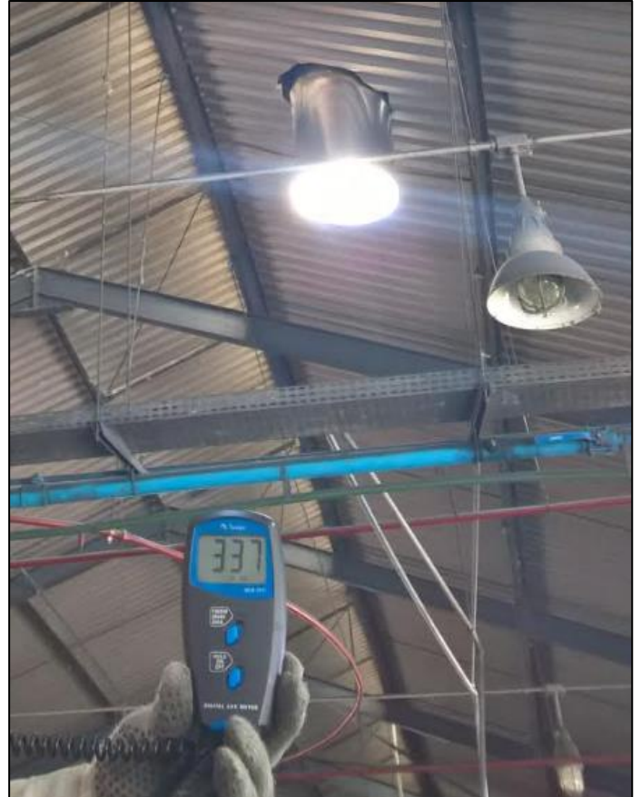
Figura 5: Sistema de Iluminação natural instalado.
