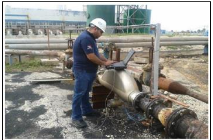
Figura 10: Flujómetro Coriolis instalado para la transferencia fiscal.
