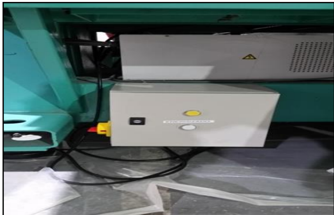
Figura 1: Quadro de comando.
