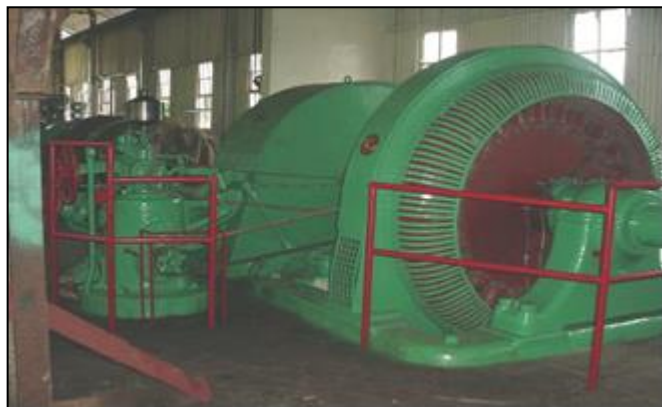
Figura 1: Sala de máquina de la PCH El Guaso (Guantánamo, Cuba). Fuente: Los autores, (2018).
