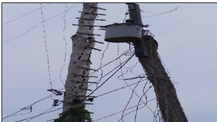
Figura 15: Escada improvisada para subir no poste.
